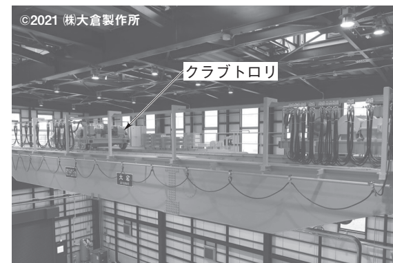
【クラブトロリ式天井クレーン】
